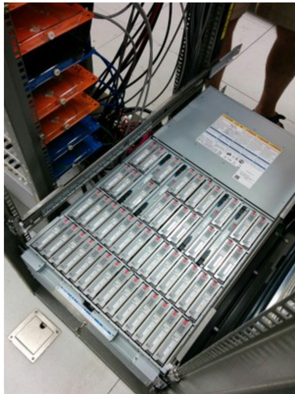
Un des 7 châssis contenant les disques
