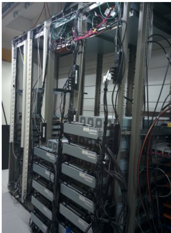
Installation terminée, vue arrière
